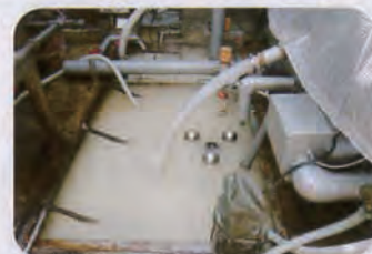
稼働1時間後のピット
