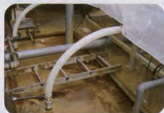
油が堆積しているピット
